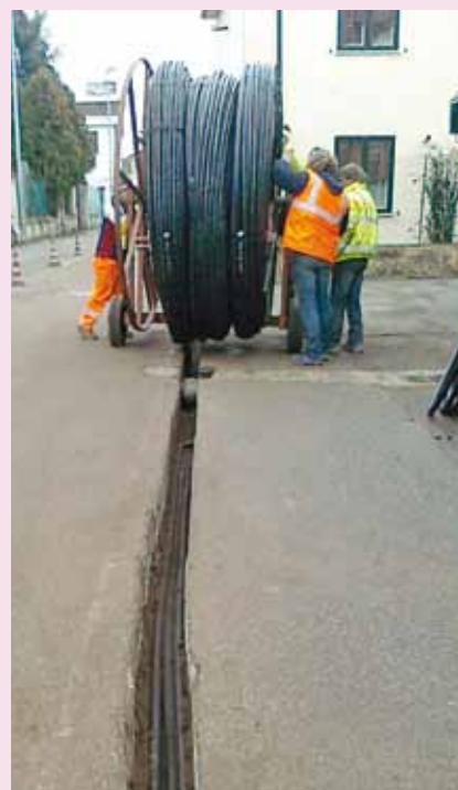
IL POSIZIONAMENTO DEI CAVI IN VIA LEOPARDI - Entro breve il problema della connessione veloce per i residenti a Cherubine, Aselogna e Asparetto resterà solo un brutto ricordo. I lavori sono coordinati da dall'assistente di cantiere geometra Alessandro Lissi, e sotto la costante presenza del collaboratore tecnico Rosario Verdura della ditta esecutrice Valtellina S.p.a
